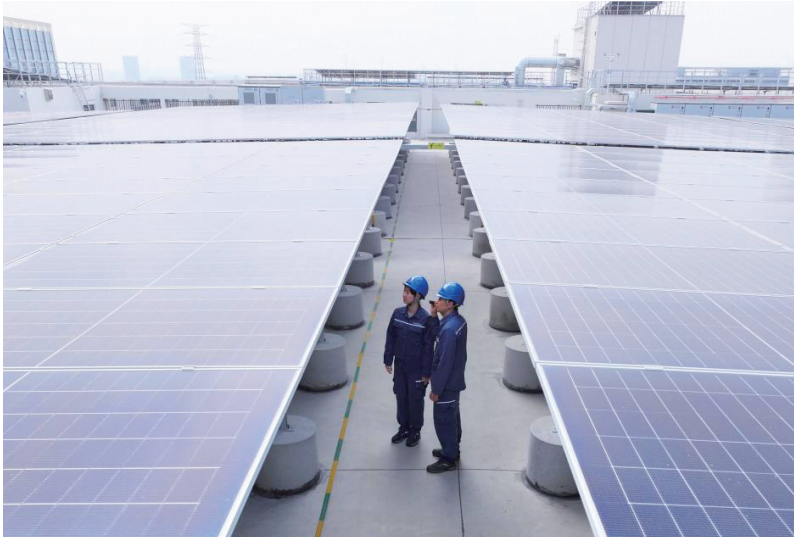
佛山顺德供电局容桂供电所工作人员走进广东川崎近零碳产业园,检查设备运行情况。
