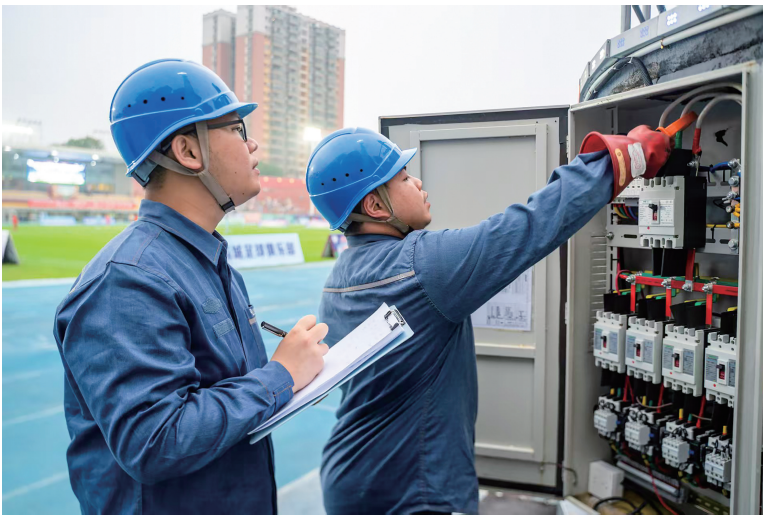
三水供电局工作人员在改造后的灯柱配电箱开展负荷测试工作。 /通讯员李杰摄
