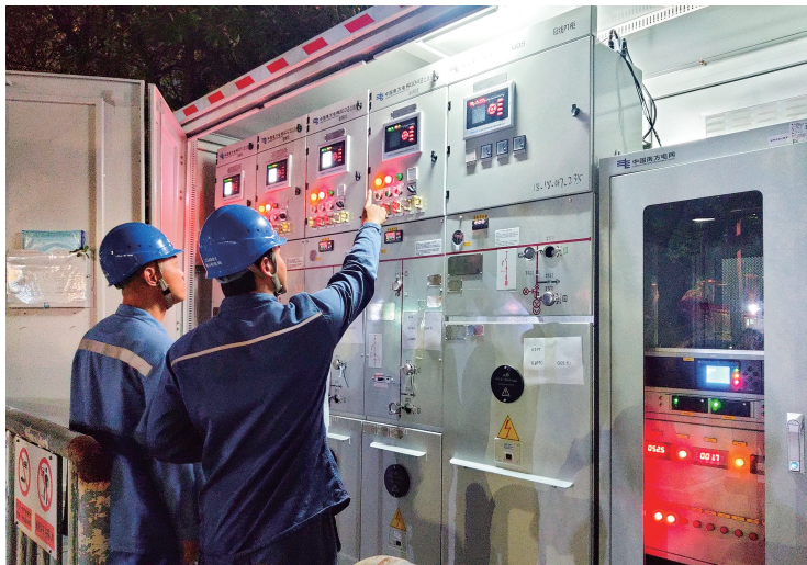
南海供电局丹灶供电所工作人员对新建公用户外开关箱进行检查调试。 /通讯员徐婉婷摄
